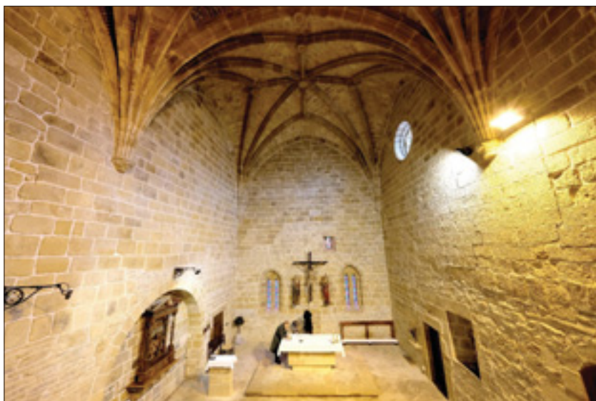
Fig. 8. San Martín de Askizu, interior de la nave, hacia el presbiterio; obsérvense, en los paramentos, las rugosidades que señalan la presencia de las discontinuidades .
