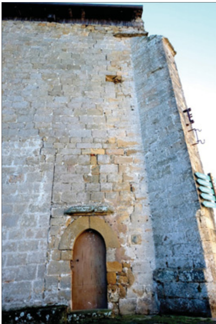
Fig. 13. San Martín de Askizu, fachada septentrional, tramo occidental, con su puerta plana, plenamente rural, azarosamente aparejada con las fábricas colindantes.
