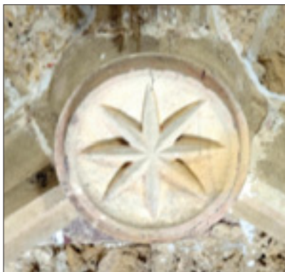
Fig. 18. San Martín de Askizu, bóveda este, clave del tercelete sur: Estrella simple de ocho puntas.
